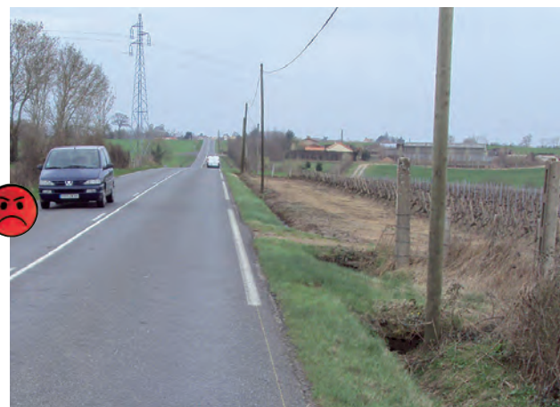
Fossés proches de la chaussée, têtes de buse non protégées, poteaux... Les accotements de nombreuses routes à trafic faible ou modéré présentent encore des risques pour les véhicules en perdition. À défaut de pouvoir investir dans un élargissement de l'emprise, le gestionnaire peut supprimer, déplacer, voire fragiliser certains obstacles.
