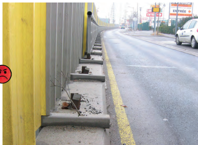
Un exemple de ce qu'il ne faut pas faire avec ces supports de palissade trop proches de la chaussée et ce garde-corps saillant.
