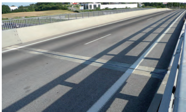
Exemple de joint d'ouvrage d'art ne présentant aucun danger pour un usager 2RM.
