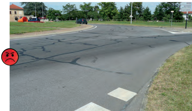
Exemple de joint de chaussée pouvant être dangereux pour un 2RM dans un giratoire.
